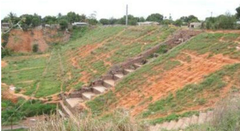
Figura 14 – Protecção da encosta na Polana-Caniço, após erosão no ano 2000
