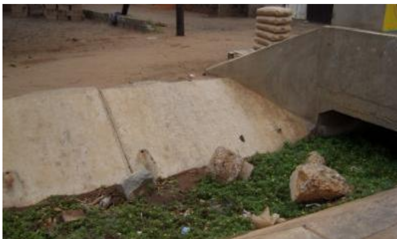
Figura 15 – Falta de limpeza afecta o funcionamento das infraestruturas
