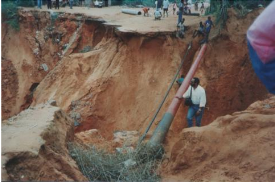
Figura 13 – Ravina profunda na Av. Julius Nyerere, surgida no ano 2000
